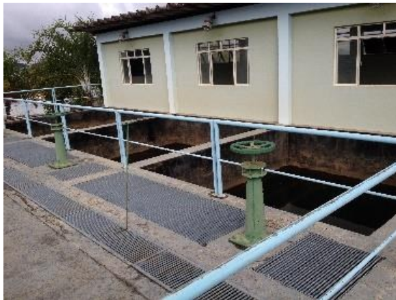
Foto 8. Vista dos 3 filtros da ETA de Piumhi.
