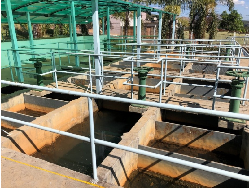
Foto 12: Floculador hidráulico – SAAE
