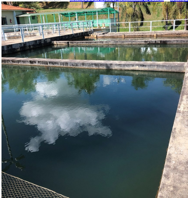
Foto 14: Decantador 03 da ETA
