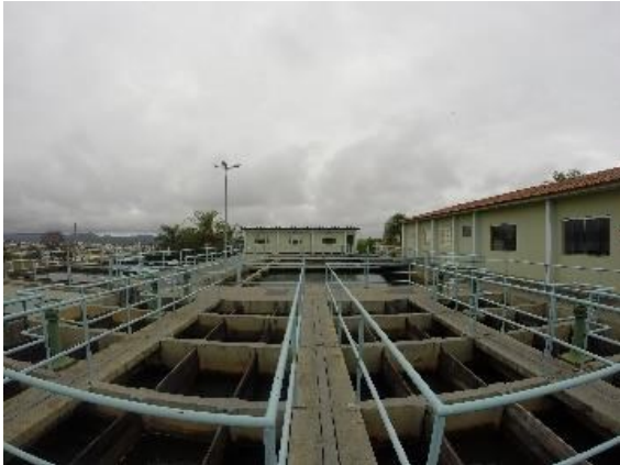
Foto 5. Vistas dos floculadores da ETA de Piumhi.
