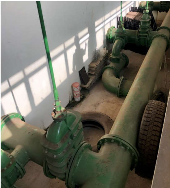
Foto 16: Barrilete hidráulico da ETA
