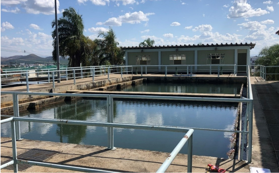
Foto 13: Decantadores 01 e 02 da ETA
