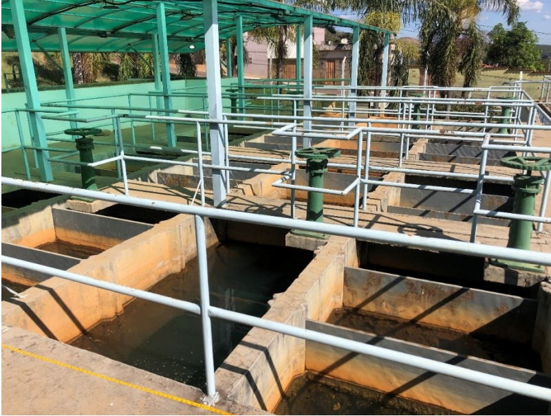
Foto 12: Floculador hidráulico – SAAE
