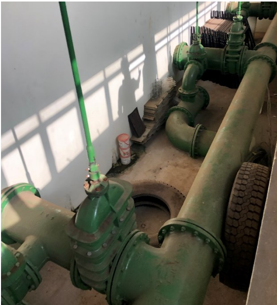
Foto 16: Barrilete hidráulico da ETA
