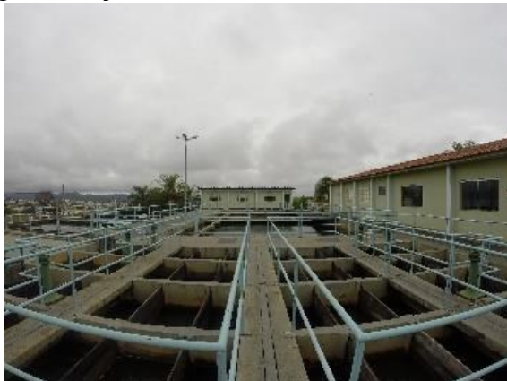
Foto 5. Vistas dos floculadores da ETA de Piumhi.
