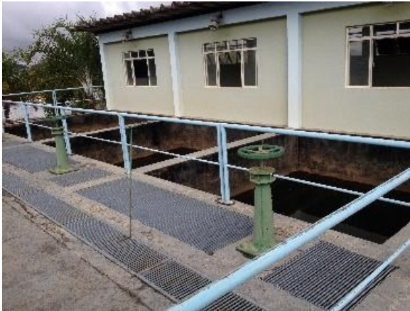
Foto 8. Vista dos 3 filtros da ETA de Piumhi.
