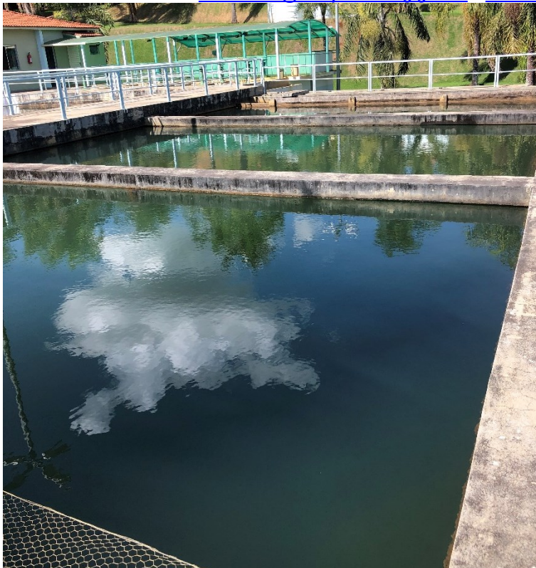
Foto 14: Decantador 03 da ETA
