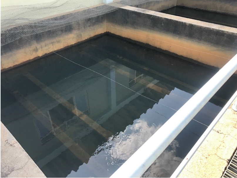
Foto 15: Filtro da ETA
